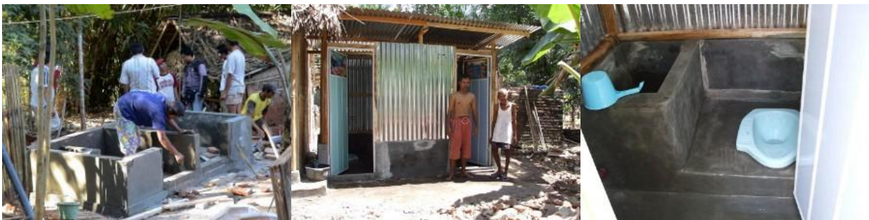
図6. 2部屋からなる半恒久的MCK(左から建設中、完成したもの、MCK内部)
